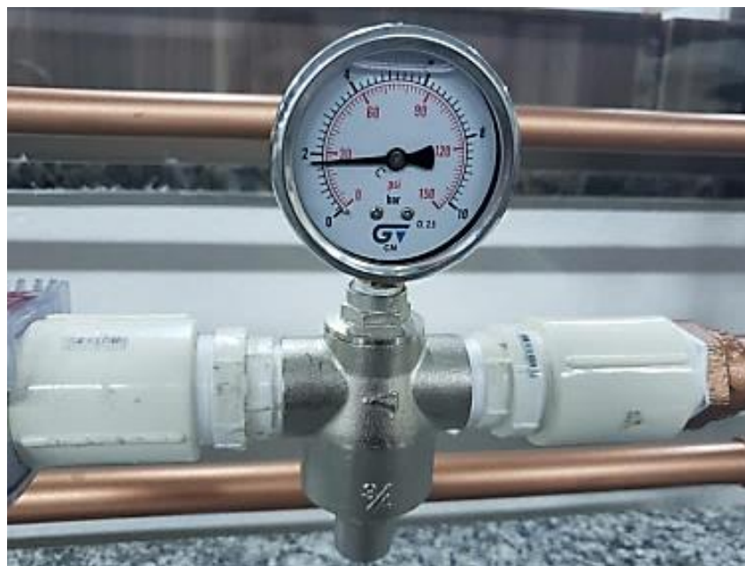
Figura 10 - Manômetro analógico e válvula redutora de pressão.
