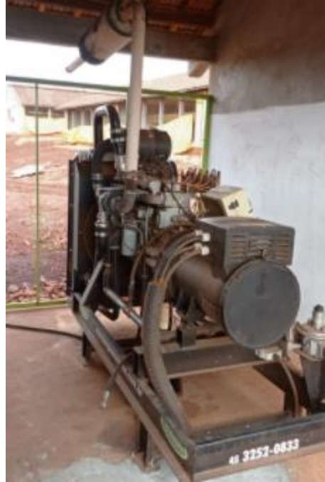
Figura 8. Conjunto Motor gerador (Unidade E).
