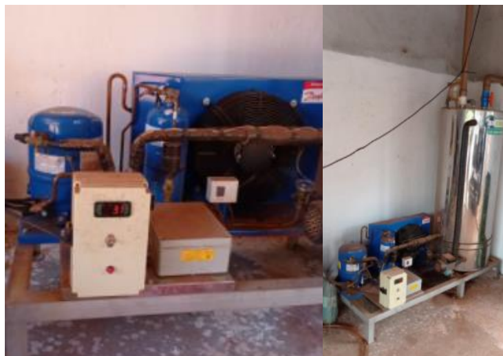
Figura 6. Sistema de refrigeração (Unidade C).
