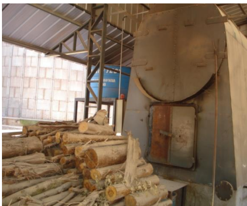
Fonte: Foto do Autor (2013) Figura 22: Caldeira Aquatubular – AWD 40
