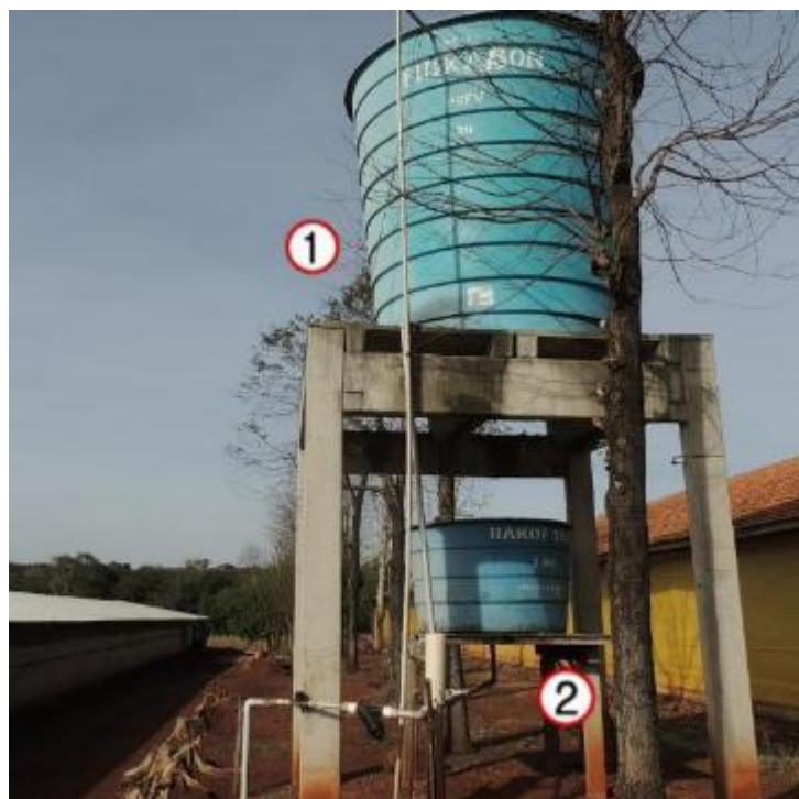
Figura 42: Sistema de abastecimento de água. (1) Reservatório 20.000 litros – nipples, nebulizadores e pad cooling (2) Reservatório 2.000 litros - nipples.
