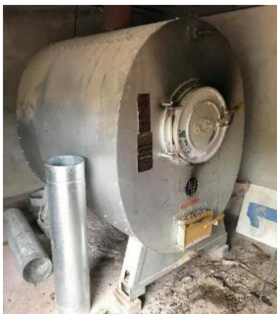
Figura 46: Sistema de aquecimento do aviário A2 – Forno a lenha.
