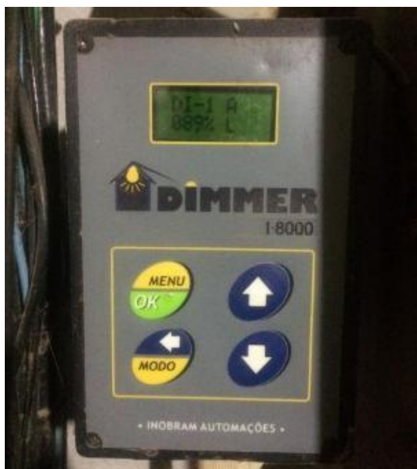
Figura 36: Sistema de iluminação - Dimmer Inobram I-8000.
