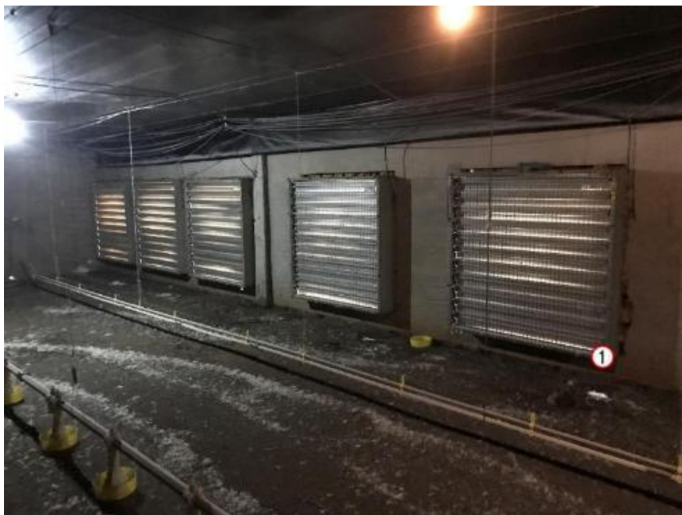
Figura 52: Sistema de ventilação – Exaustores. Face 3 – Vista interna. (1) Exaustores em funcionamento, porém, não ativos.
