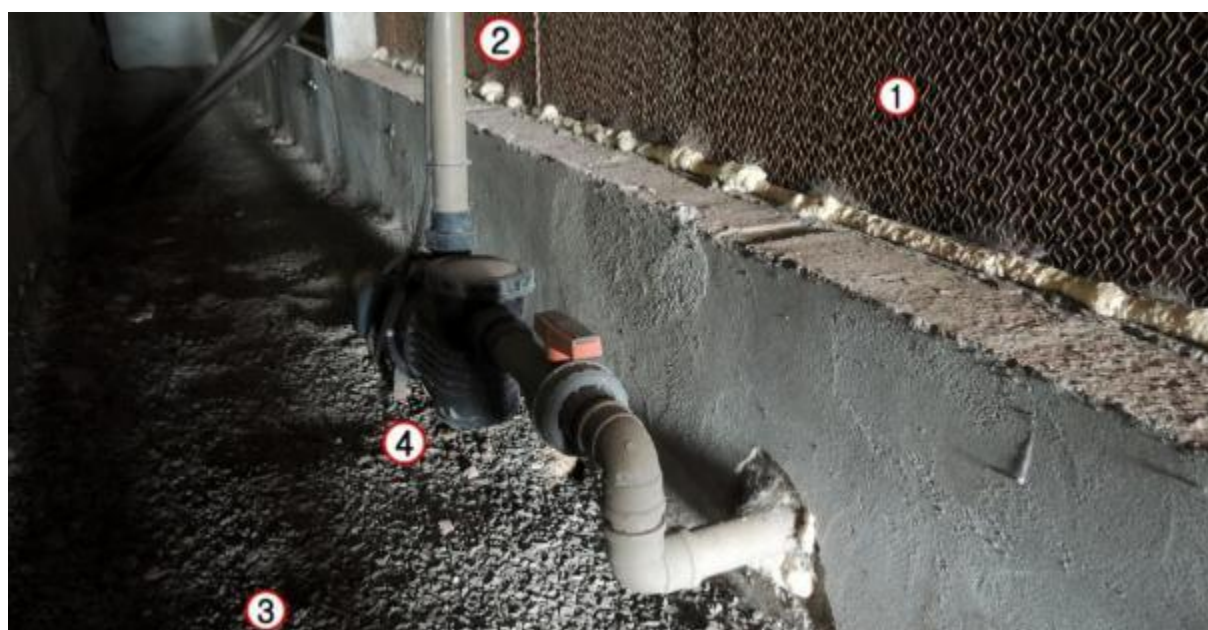
Figura 30: Sistema de resfriamento – Pad cooling . Vista lateral interna painel evaporativo de celulose. (1) Placas de celulose (2) Rede hidráulica do sistema pad cooling (3) Corredor de manutenção e duto de ar refrigerado (4) Moto bomba 3/4 cv.
