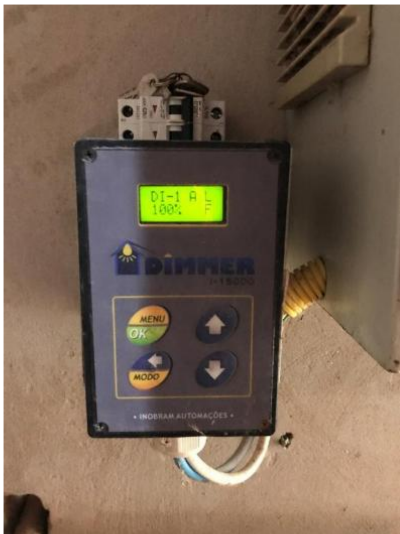
Figura 53: Sistema de iluminação - Dimmer Inobram I-15000.
