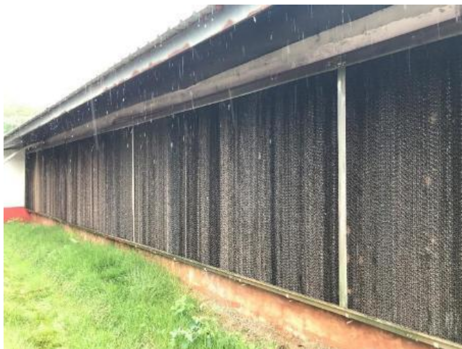
Figura 49: Sistema de resfriamento – Pad cooling – face 3.
