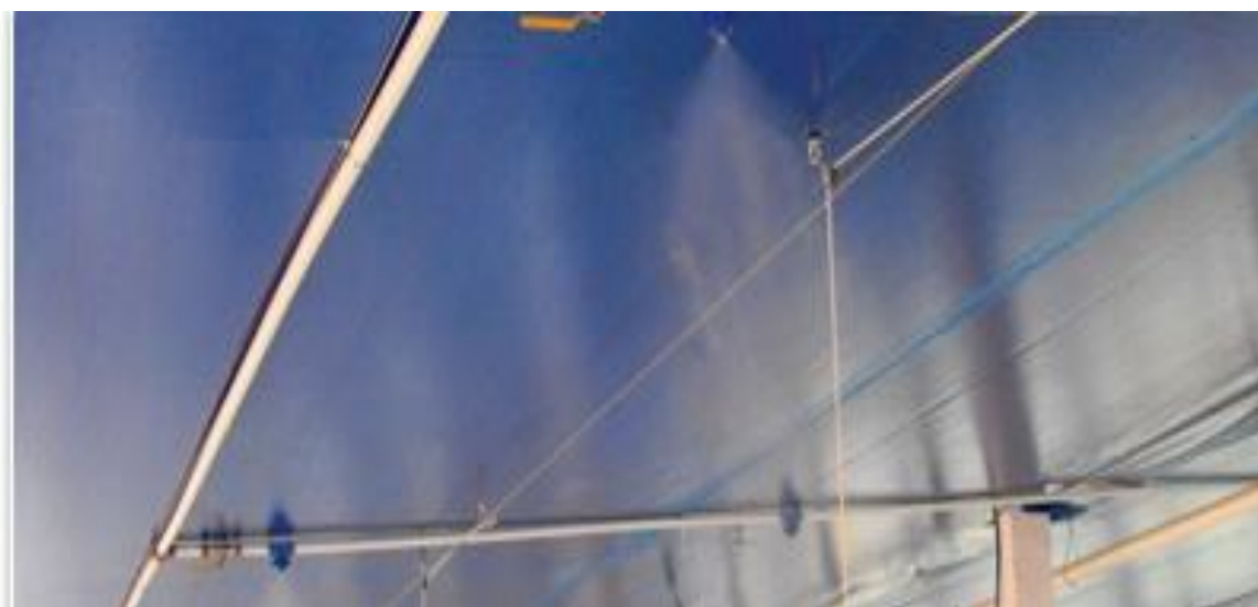
Figura 7: Sistema de nebulização – instalação. Fonte: EDEGE, 2012.
