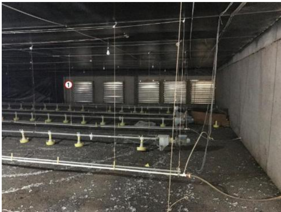
Figura 51: Sistema de ventilação – Exaustores. Face 1 – Vista interna. (1) Exaustores em funcionamento, porém, não ativos.
