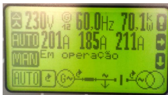
Figura 9. Tela principal do quadro de comando do grupo gerador.
