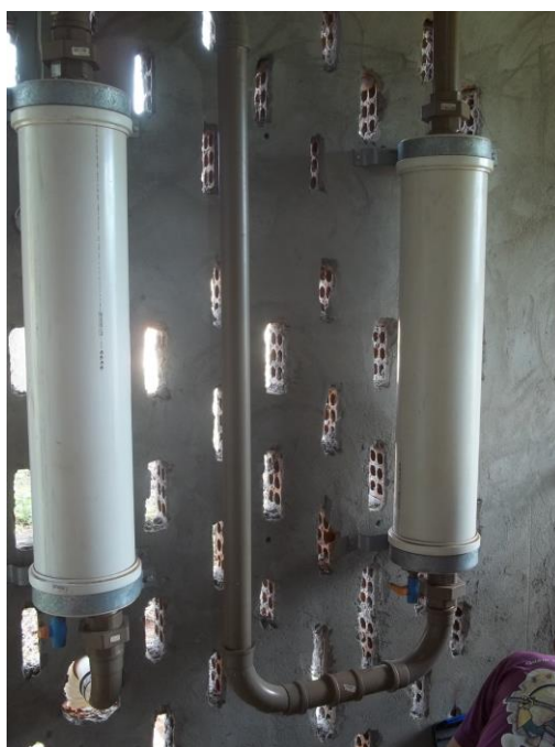
Figura 7. Filtros para biogás ligados em série antes da entrada na admissão do grupo gerador.
