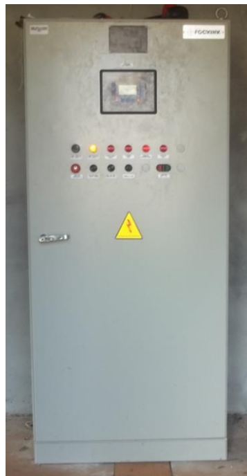
Figura 8. Quadro de comando do grupo gerador.
