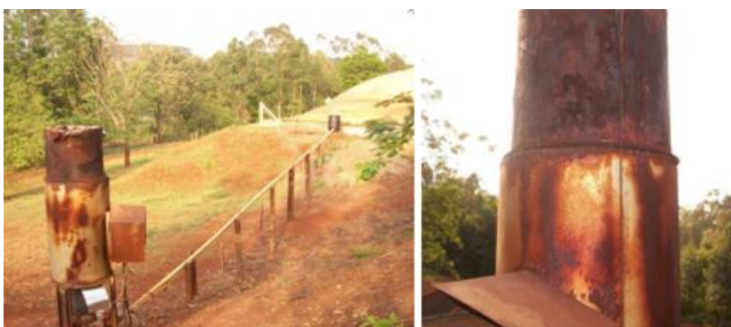
Figura 6: Queimador de Biogás
