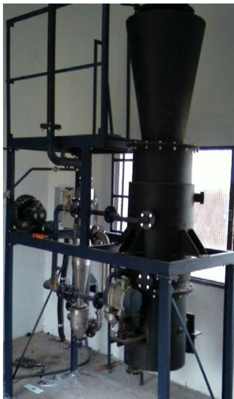
Figura 10- Unidade de gaseificação instalada no laboratório de Bioenergia.
