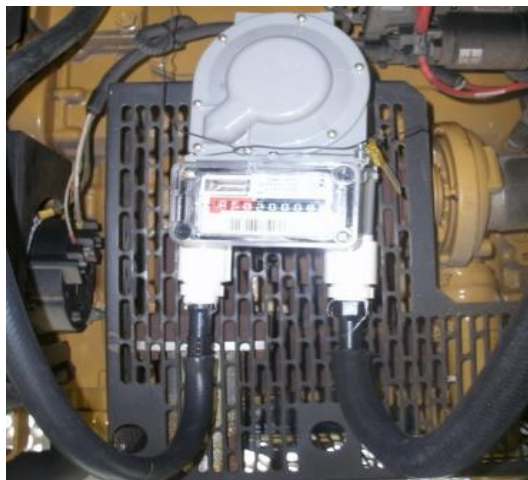
Figura 18 - Medidor de vazão de gases
