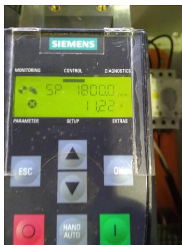
Figura 9: Inversor de Frequência Fonte: Autor
