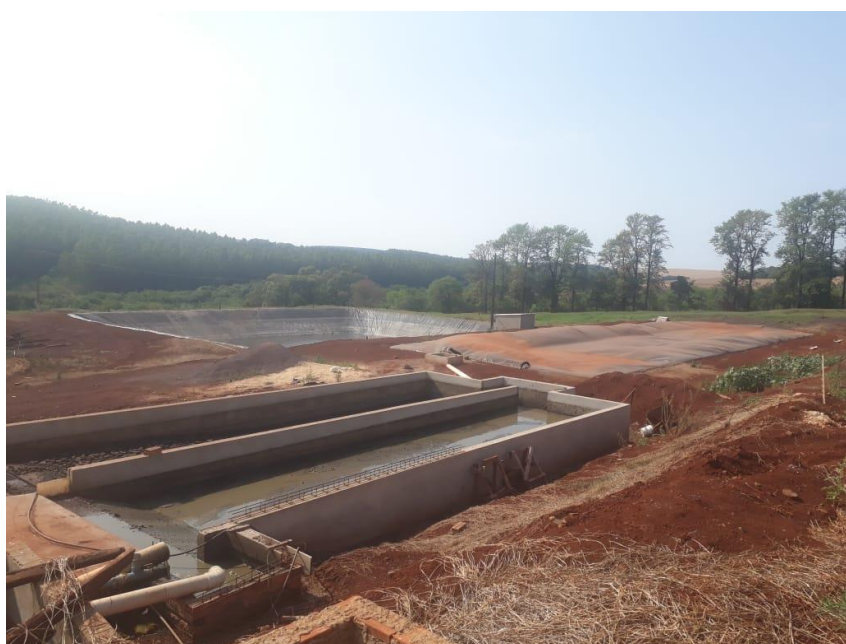
Figura 31 - Instalações do biodigestor na propriedade.
